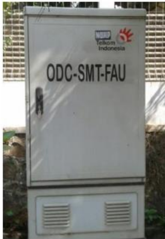
Gambar 2. 6 Optical Distribution Cabinet (ODC) [5]
