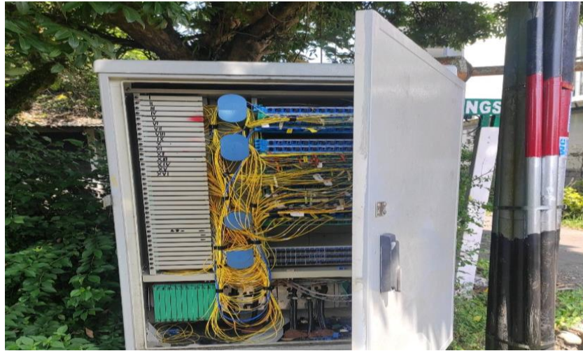
Gambar 2. 2 Optical Distribution Cabinet (ODC)
