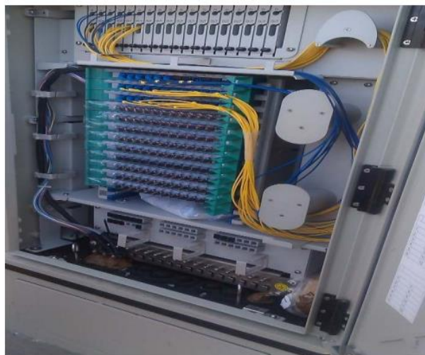
Gambar 2.2.1 Optical Distribution Cabinet (ODC) [6].
