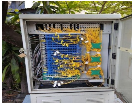
Gambar 2. 4 Optikal Distribution Cabinet (ODC) [3].
