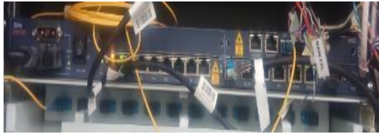
Gambar 3.7 Perangkat GPON pada cabinet BTS
