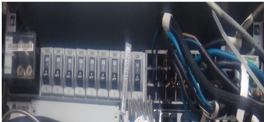
Gambar 3.5 Perangkat DCDU pada cabinet BTS
