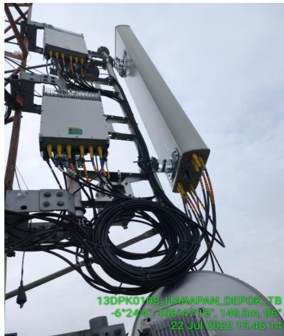
Gambar 3.18 Antena sectoral yang sudah dinstalasi
