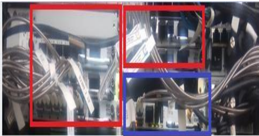
Gambar 3.6 Perangkat BBU pada cabinet BTS
