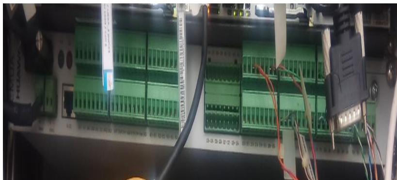
Gambar 3.9 Perangkat EMUA pada cabinet BTS
