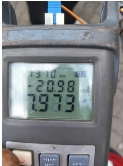
Gambar 2.7 Pengecekan redaman di ODP
