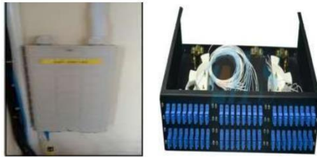
Gambar 2.3.2 Optical Distribution Frame (ODF)
