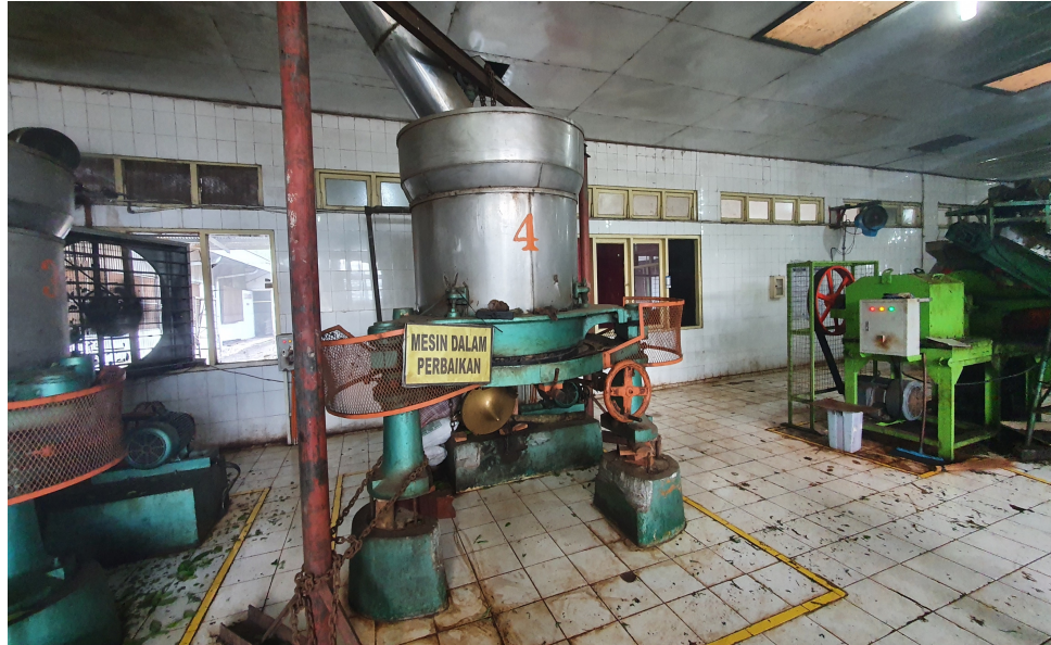
Gambar 2. 6 Mesin UT Penggilingan
