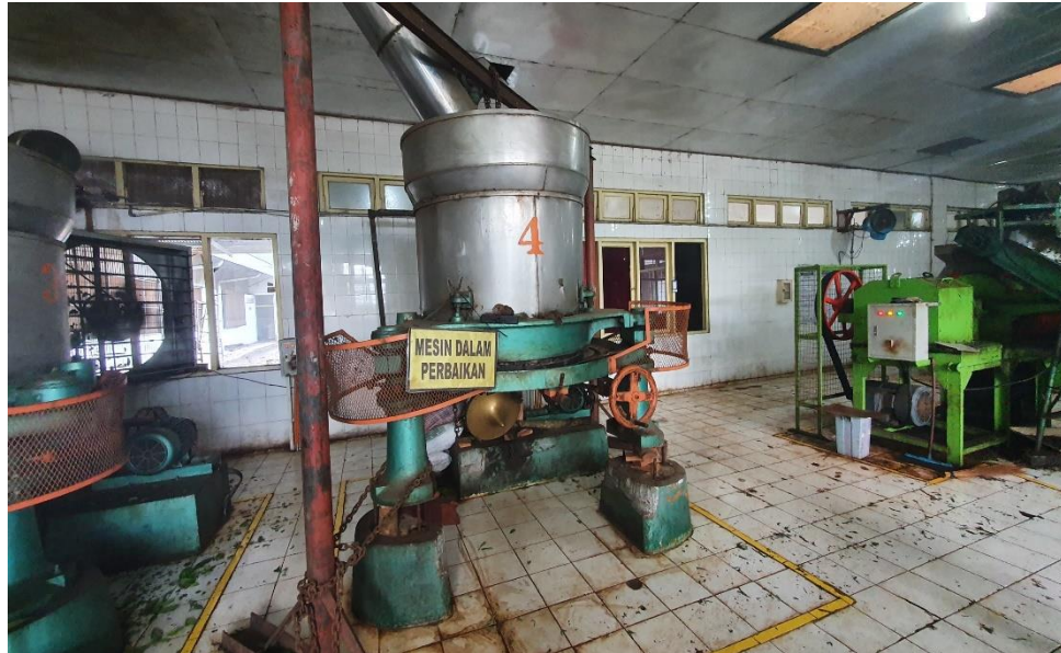
Gambar 2. 6 Mesin UT Penggilingan
