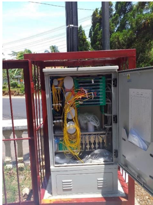
Gambar 2.3 Optical Distribution Cabinet (ODC)
