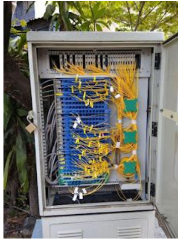
Gambar 2. 6 ODC (Optical Distribution Cabinet)
