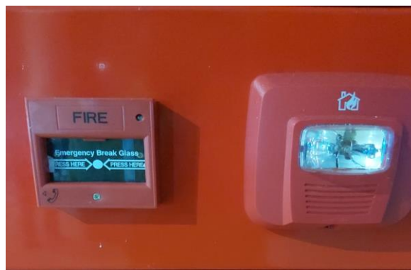
Gambar 2.5 Alarm Bell dan Indicator
