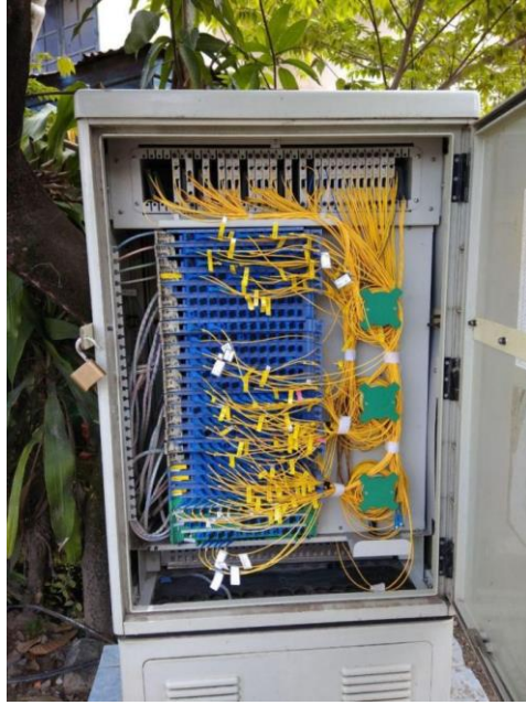
Gambar 2. 5 Optical Distribution Cabinet (ODC) [10]
