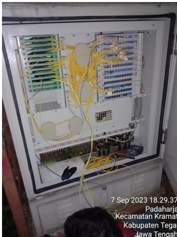
Gambar 2.3.1 Gambar ODC ( Optic al Distribution Cabinet )
