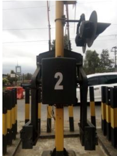
Gambar 4 Barrier 2 Pada Pintu Perlintasan JPL 360
