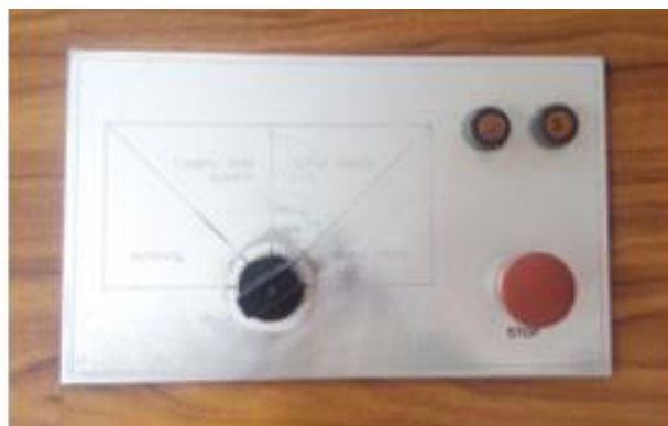
Gambar 6 Panel Operator Pada Meja Pelayanan Pintu Perlintasan
