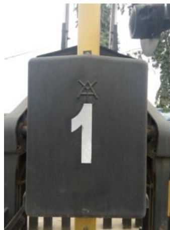
Gambar 3 Barier 1 Pada Pintu Perlintasan JPL 360
