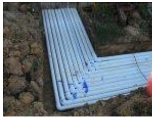
Gambar 2.9 Drain pada Kolam Renang [2]
